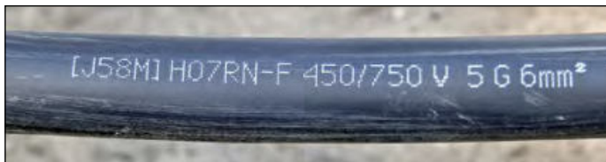
Na terenie budowy stosuje się przewody giętkie miedziane typu H07RN-F.
