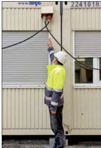
Zamontowanie gniazd i wtyczek instalacji elektrycznej na zbyt dużej wysokości uniemożliwia ich łatwą obsługę.
