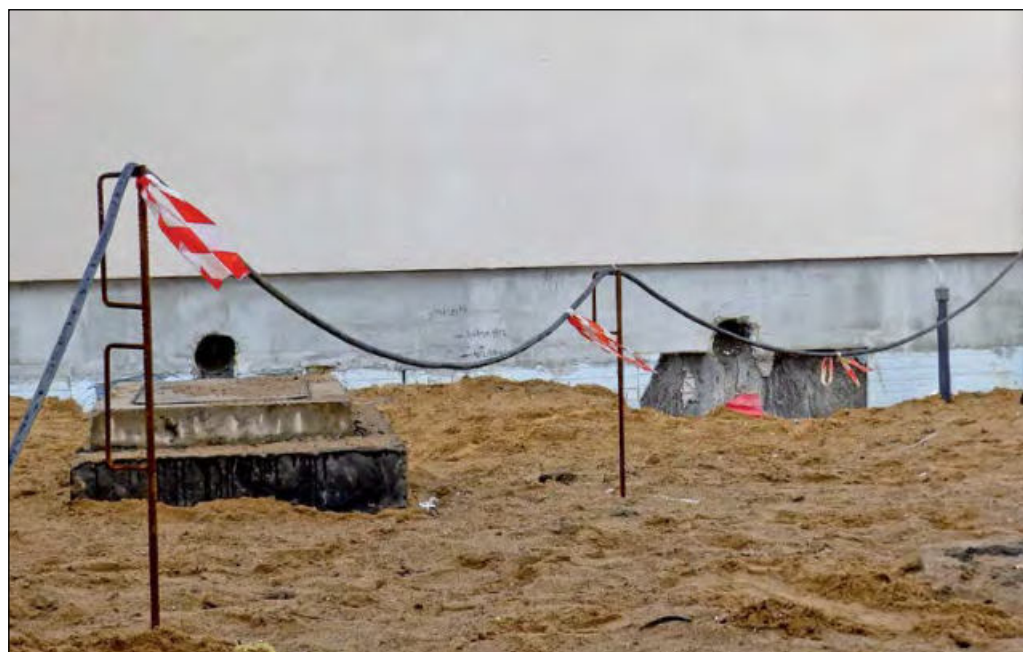
Przewody elektryczne układa się tak, aby nie były narażone na uszkodzenie mechaniczne od prowadzonych prac budowlanych, w tym celu podwiesza się je lub układa poza miejscami przejść i ruchu pojazdów.
